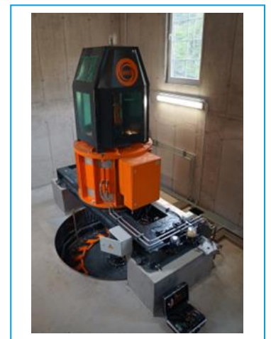
Abbildung 1 WWS Kaplan Generator
